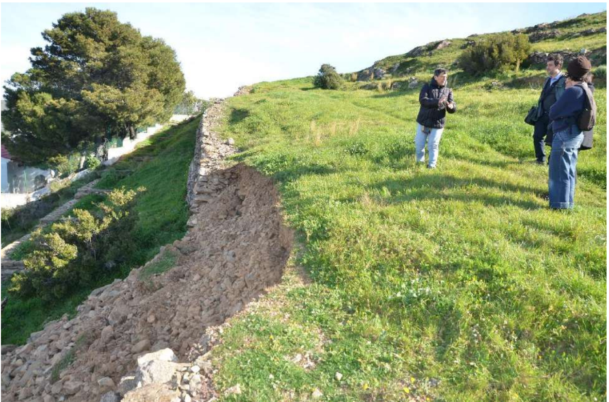
Fig. 04 - Esvoranc en forma de mitja lluna produït pel col·lapse, de 7.40 m de llarg per 1.25 m d'ample. La runa es diposita sobre el talús i arriba fins al camí de ronda, tocant els dos bancs. 19/02/2020
