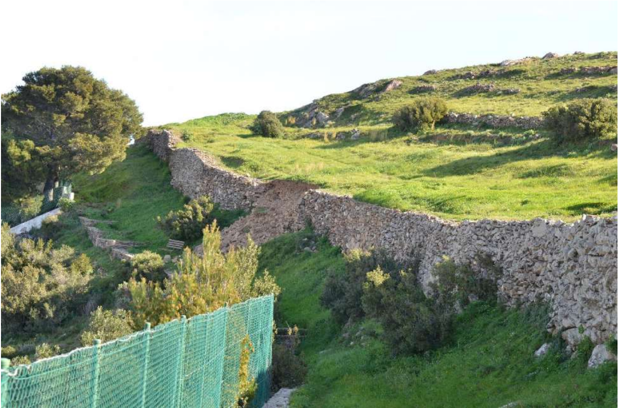
Fig. 03 - Àmbit d'intervenció. De baix a dalt: parcel·les A8 i A9 del Sistema de Parcs i Jardins, camí de ronda, talús, marge de contenció de la muralla visigòtica (on es produeix el col·lapse) i terreny superior fins al primer bancal de pedra (on s'hi observen dos arbustos). 19/02/2020
