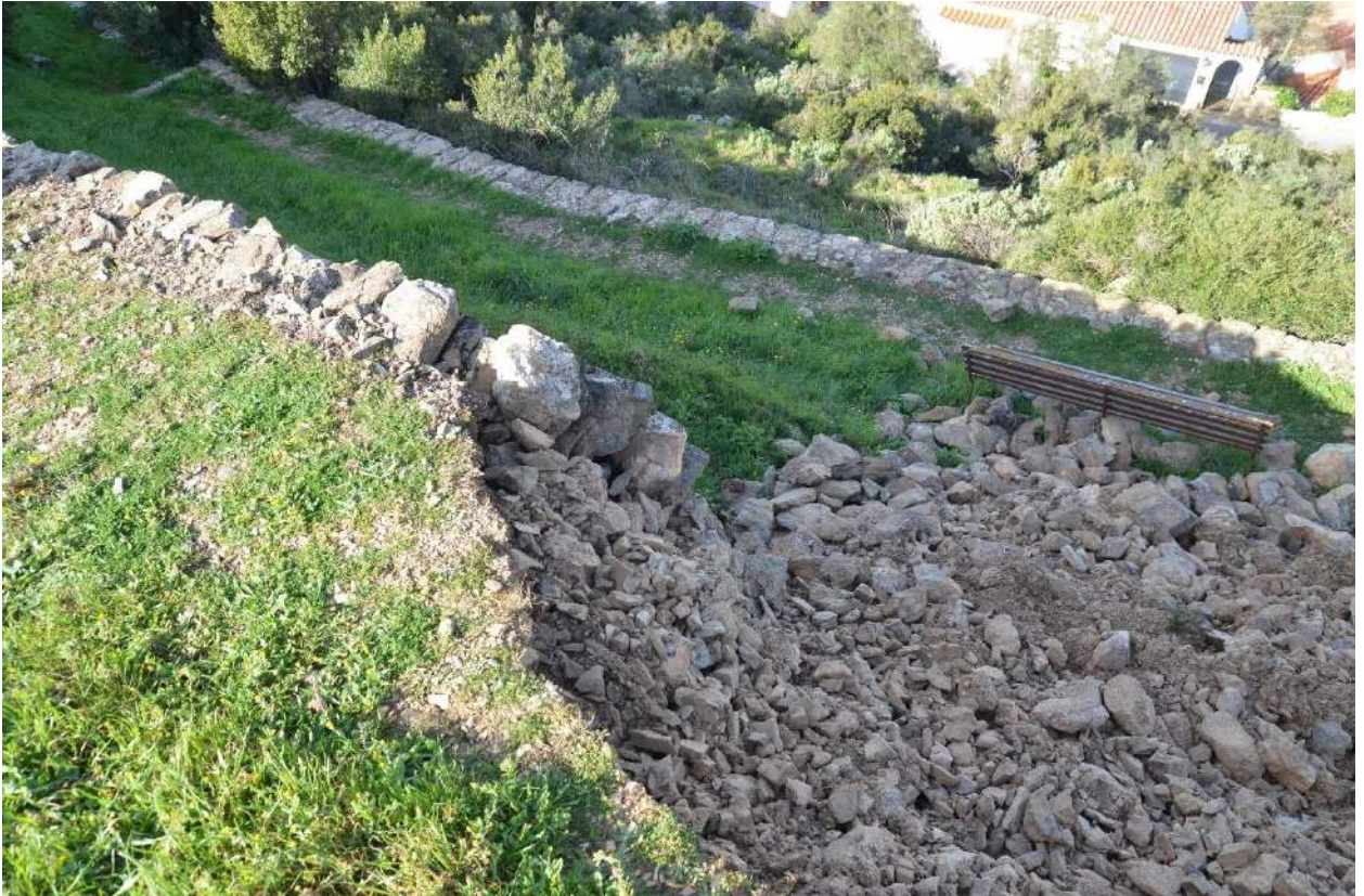
Fig. 05 - Extrem esquerre de l'esvoranc produït pel col·lapse, vist des de la plataforma superior del terreny. 19/02/2020
