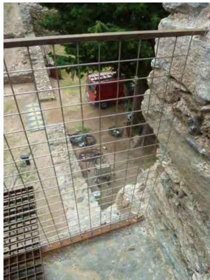
Torre de la muralla medieval interior (2016), d'acer corten i malla electrosoldada d'inoxidable
