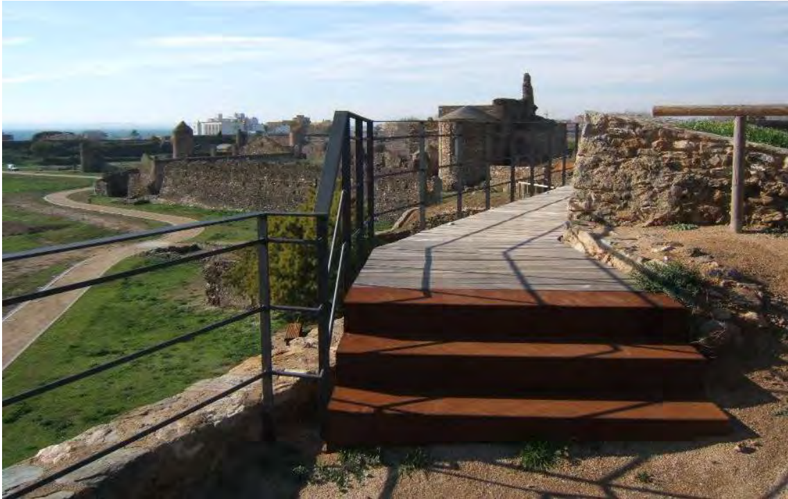
Baluard de Sant Andreu. Proteccions d'acer pintat color gris antracita i barrots horitzontals, paviment de llates de fusta i graons d'acer corten. També apareix la barana provisional de posts de fusta
