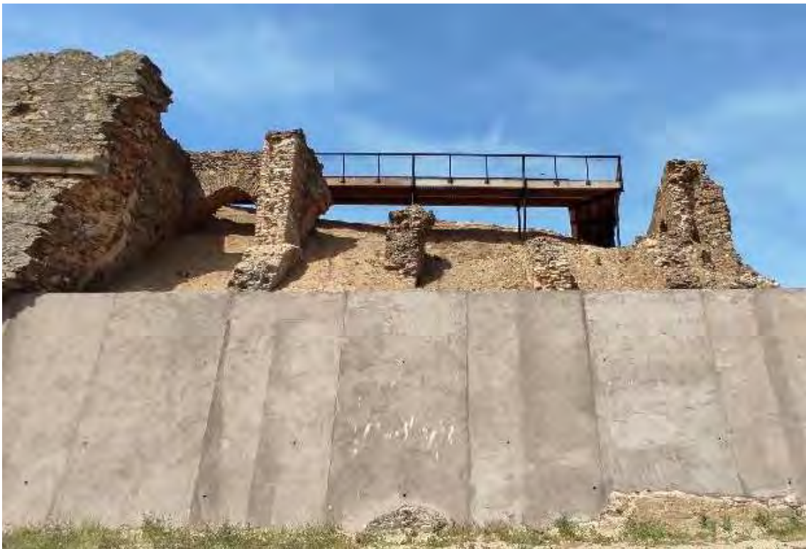
Barana amb muntants i passamans tubulars d'acer i malla tipus x-tend d'acer inoxidable
