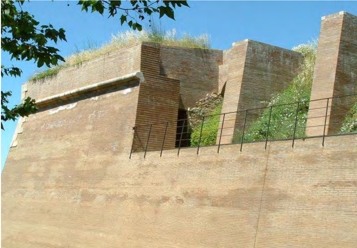
Baluard de Sant Jaume, barana d'acer pintat gris antracita amb proteccions horitzontals
