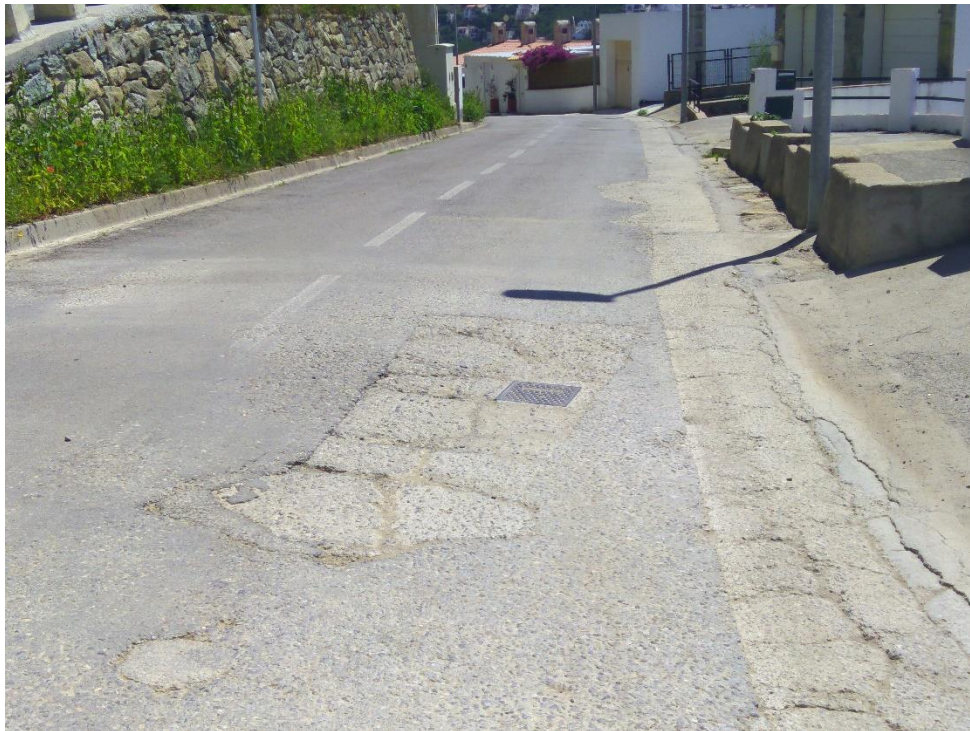
Figura 13. Tram amb capa de rodadura trencada i flonjalls localitzats
