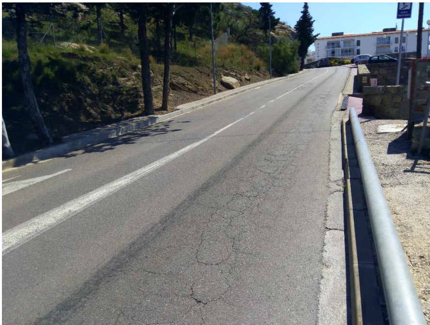
Figura 9. ferm amb pell de cocodril i lleugers enfonsaments localitzats
