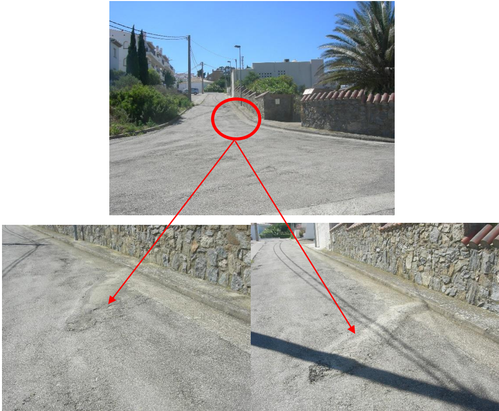
Figura 31. Estat actual de la capa de rosament. Presència de trencaigües no homologats
