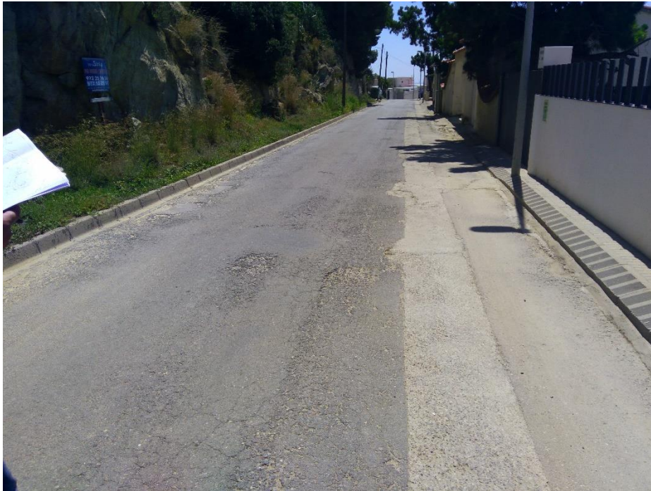
Figura 12. Paviment amb pell de cocodril i rasa de formigó al lateral dret
