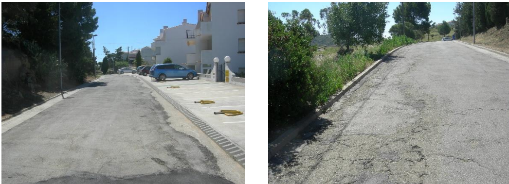
Figura 32. Estat actual de la capa de rodament
