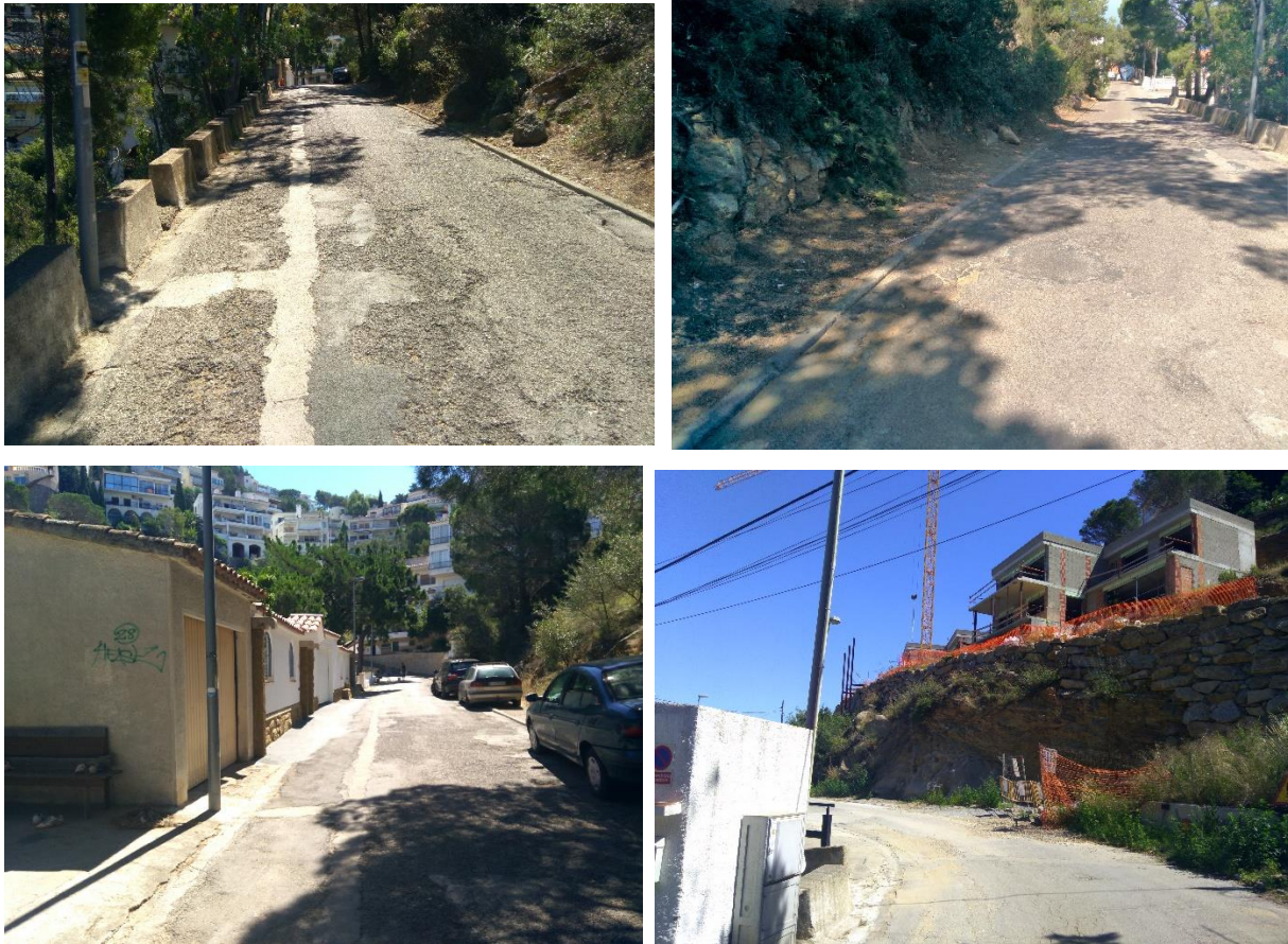
Figura 35. Estat actual de la capa de rodament
