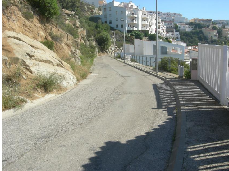
Figura 26. Estat actual de la capa de rodament
