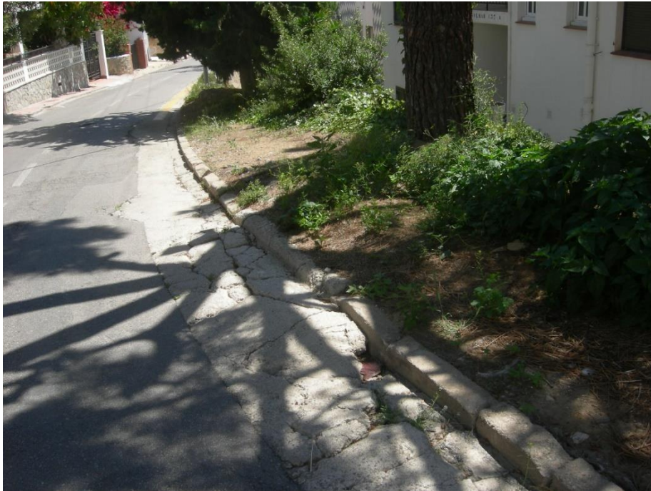
Figura 16. Descalçament degut a la presència d'arrels
