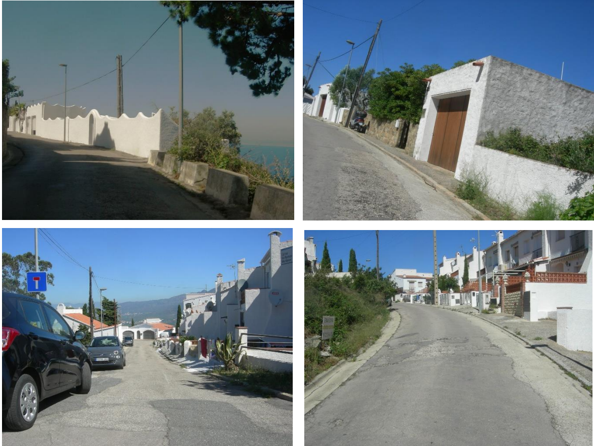
Figura 28. Estat actual de la capa de rodament
