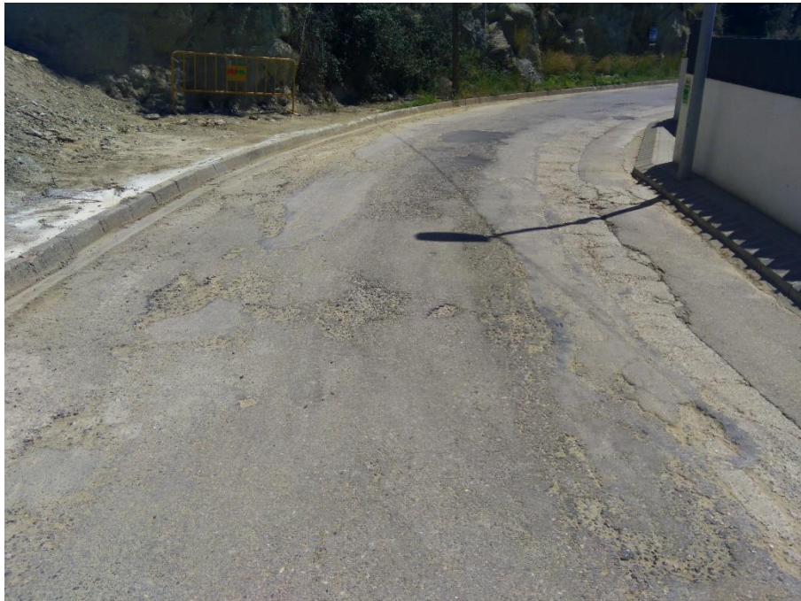
Figura 11. Capa de rodadura trencada i amb flonjalls localitzats
