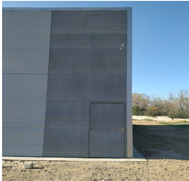
Figura 9.- Revestiment exterior ondulat actual amb perfil de xapa «miniona» cega i perforada.
