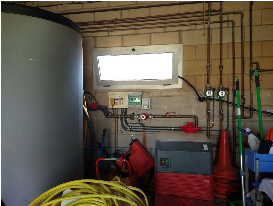
Figura 2: Sala de calderes Camp de futbol La Vinyassa
