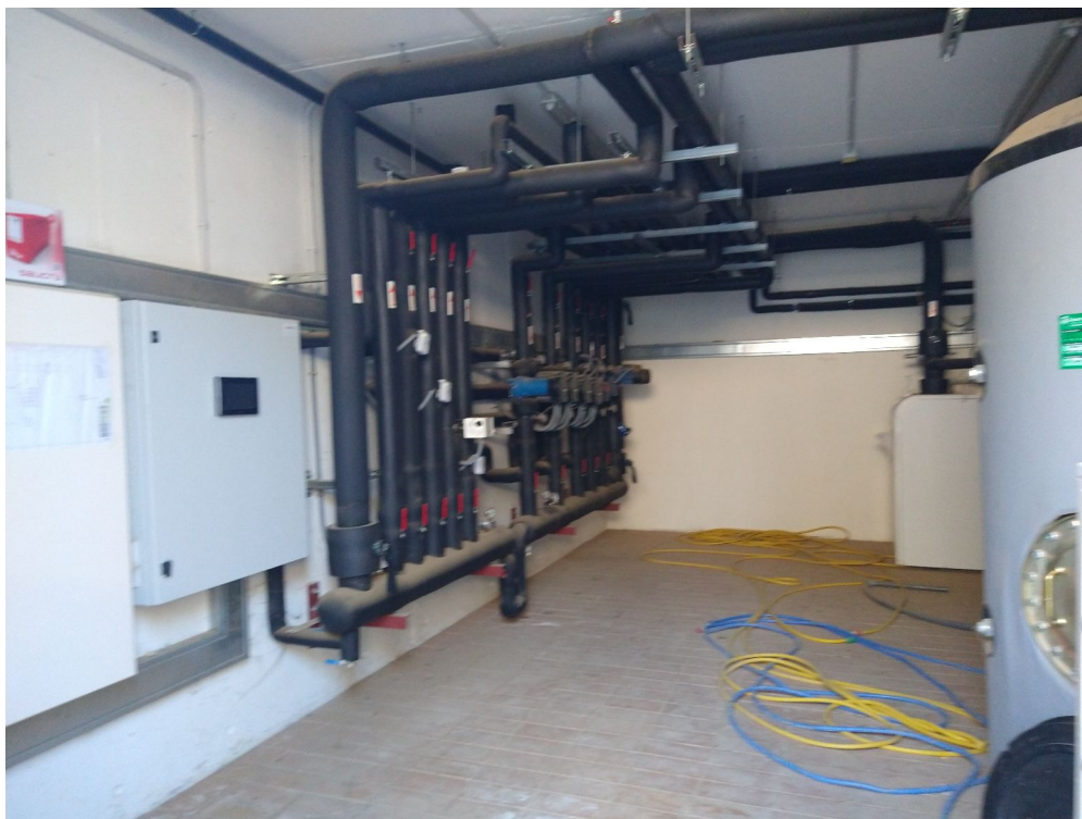
Figura 3: Sala calderes Escola Montserrat Vayreda
