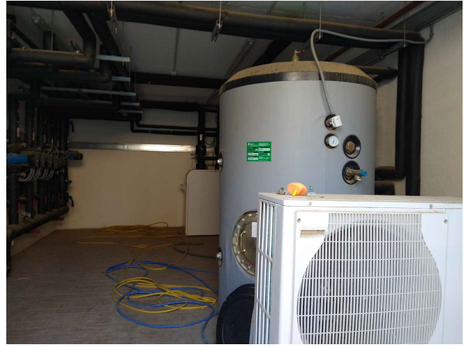
Imatge Sala Calderes
