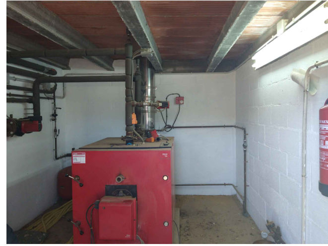
Imatge Sala Calderes
