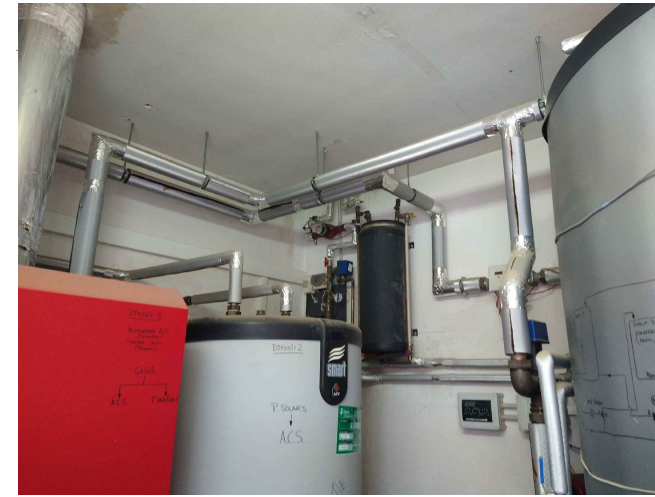
Imatge Sala Calderes
