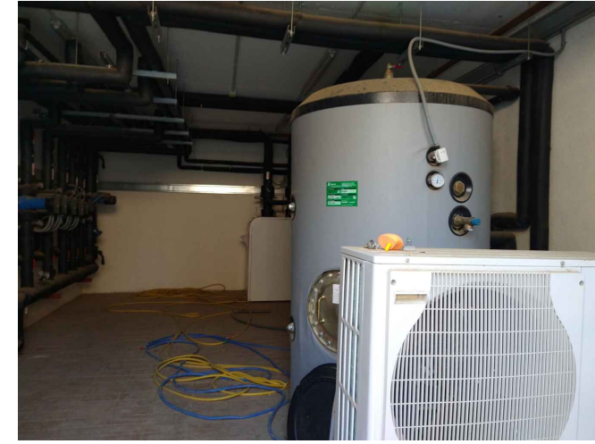
Imatge Sala Calderes
