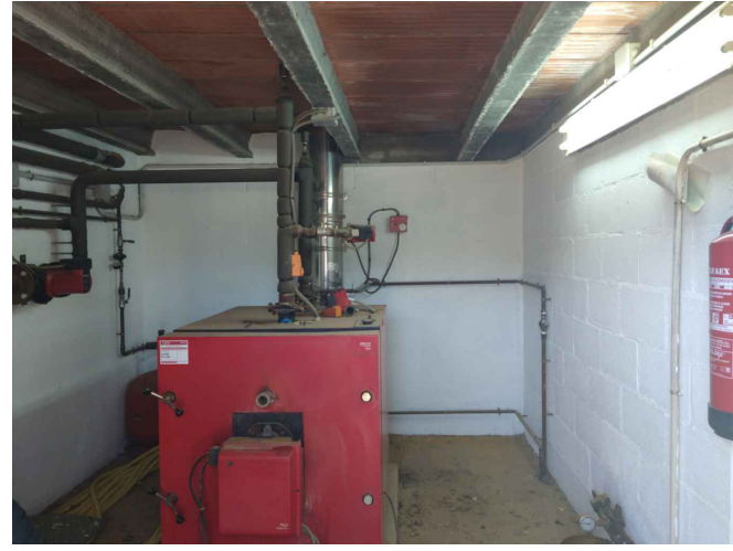
Imatge Sala Calderes
