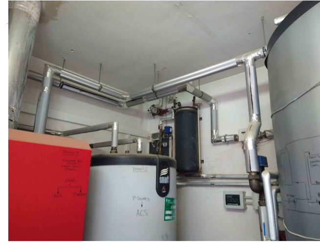
Imatge Sala Calderes
