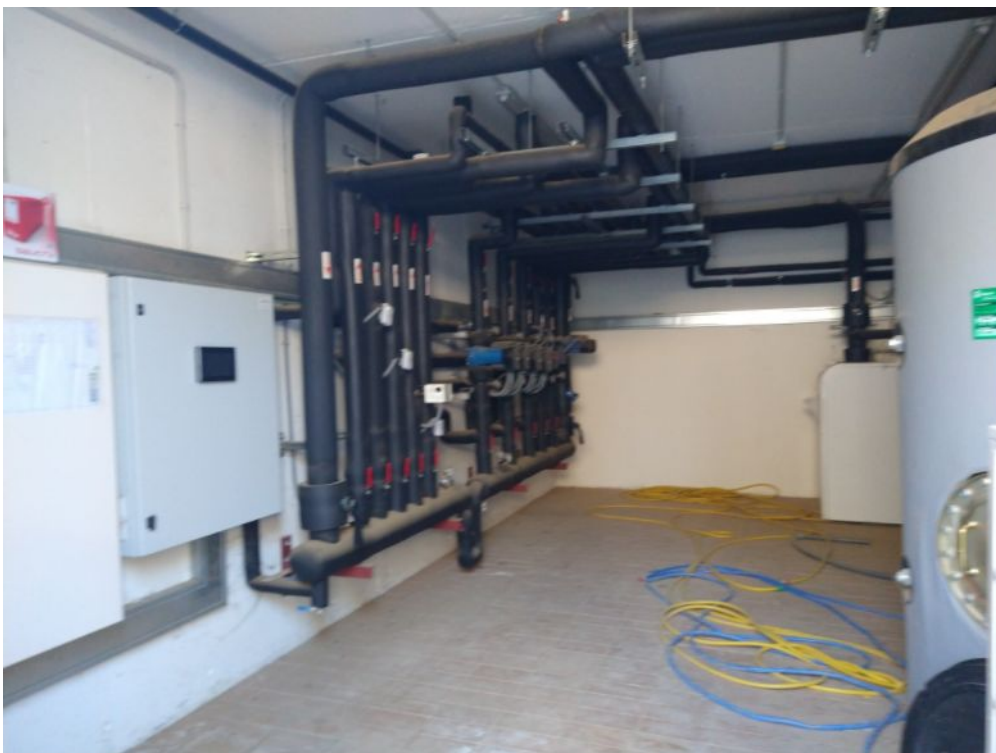
Figura 3: Sala calderes Escola Montserrat Vayreda
