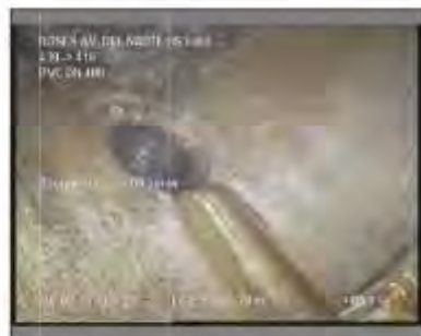
Foto: 4_1_7_24022021_092456_A.JPG 52,7m, Acometida a las 08 horas
