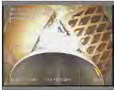
Foto: 16_1_B_19022021_100201_A.JPG 17m, Inspección interrumpida
