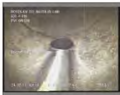
Foto: 4_1_4_24022021_092199_A.JPG 32,3m, Acometida a las 03 horas
