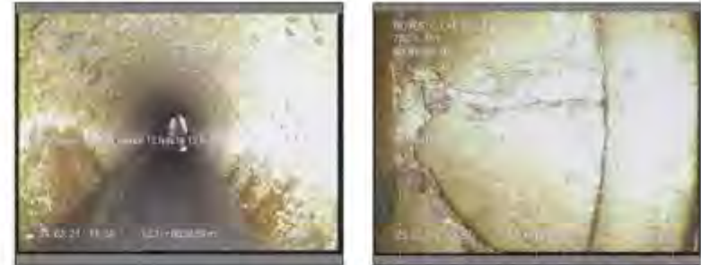
Figura 58. Col·lector amb paret interna erosionada entre pous de registre 745 - 708
