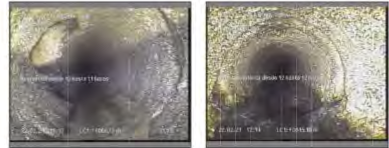
Figura 43: Col·lector amb filtracions a les seves juntes i espaiament, entre pous de registre 803 – 804. Col·lector amb filtracions a les seves juntes i avançat estat de deteriorament.
