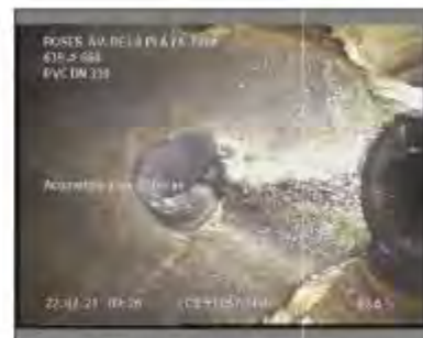
Foto: 25_1_11_22022021_092827_A.JPG 57,3m, Acometida a las 10 horas
