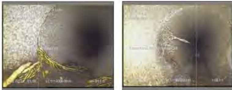
Figura 42. Col·lector amb arrels a les seves juntes entre pous de registre – 802. Col·lector amb arrels a les seves juntes entre pous de registre 802 - 803
