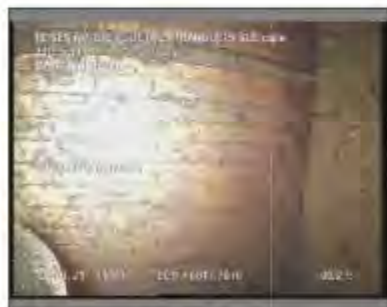
Foto: 19_1_2_02032021_112653_B.JPG 17,7m, Pozo oculto (arqueta)
