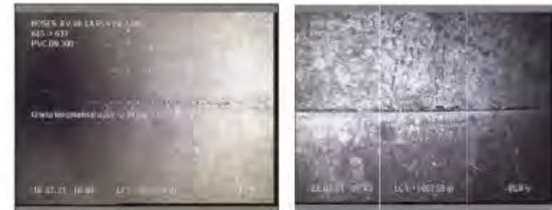
Figura 52: Fissura longitudinal entre els pous de registre 640 - 639
