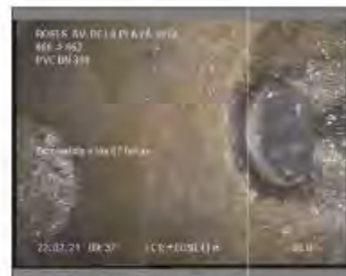
Foto: 26_1_8_22022021_093938_A.JPG 30,4m, Acometida a las 07 horas
