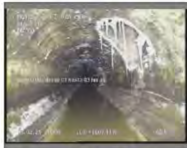
Foto: 2_1_2_18022021_110842_A.JPG 7,6m, Acometida desde 01 hasta 03 horas
