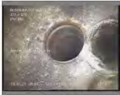
Foto: 1_1_12_23022021_091155_A.JPG 60,9m, Acometida a las 11 horas
