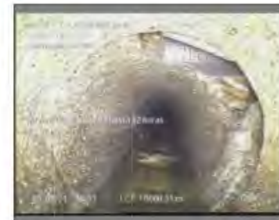
Figura 60: Col·lector amb filtracions a les seves juntes i avançant estat de deteriorament entre pous de registre 773 - 7015
