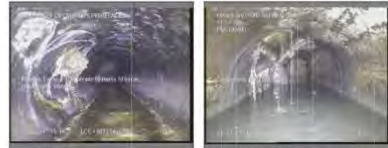
Figura 24: Erosió de la solera entre pous de registre 793 – 703. Falla estructural del col·lector. Tram entre pous de registre 717 – 705.
