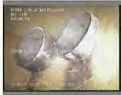
Foto: 22_1_8_22022021_082501_A.JPG 47,1m, Acometida desde 03 hasta 05 horas
