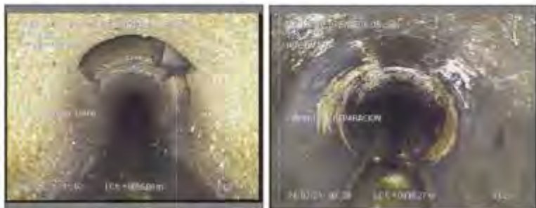
Figura 33: Escames mal connectada entre pous de registre 439 – 440. Falla estructural del col·lector entre pous de registre 429 – 430.
