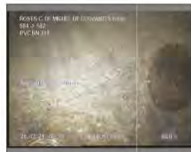
Foto: 10_1_5_26022021_094049_A.JPG 51,2m, Acometida a las 05 horas
