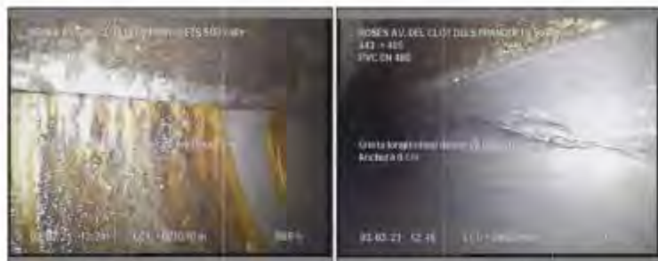
Figura 65: Col·lector amb fissura longitudinal entre pous de registre 443 - 441
