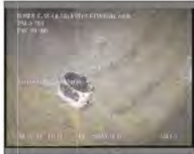
Foto: 14_1_4_18022021_111301_A.JPG 53,1m, Acometida a las 06 horas
