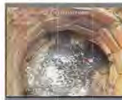
Figura 11: Infiltracions en pou de registre d'obra de fàbrica. Pou 154
