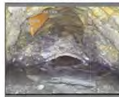
Figura 21: Fallada estructural del col·lector entre pous de registre 805 – 806
