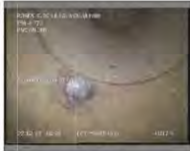
Foto: 23_1_E_22022021_083148_A.JPG 45,1m, Acometida a las 10 horas
