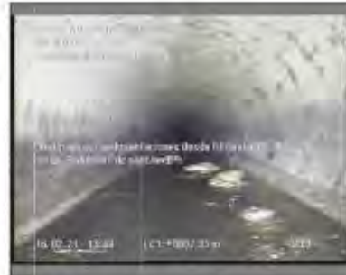
Foto: E_1_2_18022021_130721_A.JPG 7,3m, Obstrucción por sedimentaciones desde 04 hasta 08 horas. Reducción de sección 0 %
