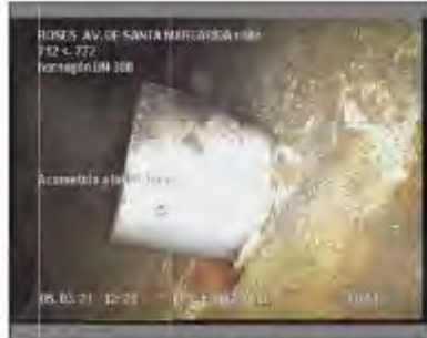
Foto: 60_1_6_05032021_122608_A.JPG 27,9m, Acometida a las 05 horas
