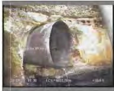
Foto: 42_1_6_24022021_113256_A.JPG 33,7m, Acometida a las 05 horas
