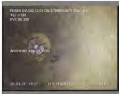
Foto: 21_1_7_02032021_121402_A.JPG 40,9m, Acometida a las 04 horas
