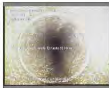
Foto: 40_1_6_23022021_125501_A.JPG 26,3m, Corrosión Interior desde 12 hasta 12 horas
