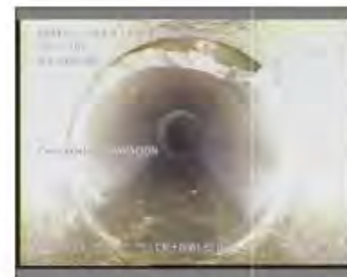
Foto: 40_1_11_23022021_125615_A.JPG 61,8m, Comentario
