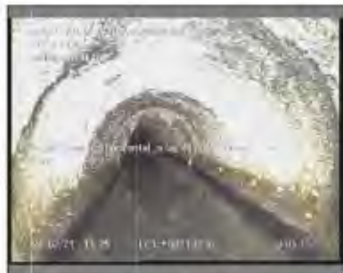
Foto: 45_1_2_24022021_132727_A.JPG 11.4m, Desplazamiento horizontal, a las 11 horas. Despl. 0 cm
