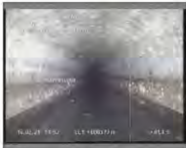
Foto: 7_1_4_16022021_145447_A.JPG 3,7m. Inspección interrumpida.
