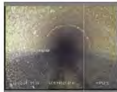
Foto: 28_1_5_22022021_112507_A.JPG 21m, Inspección interrumpida
