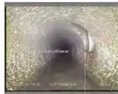
Foto: 19_1_6_02032021_112759_A.JPG 31,3m, Acometida desde 02 hasta 03 horas
