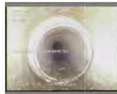
Foto: 40_1_12_23022021_125655_A.JPG 62,9m, Comentario
