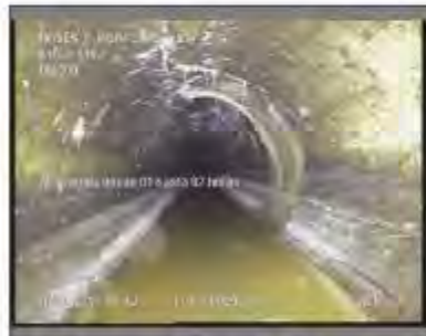
Foto: 1_1_4_18022021_104431_A.JPG 25,9m, Acometida desde 01 hasta 02 horas
