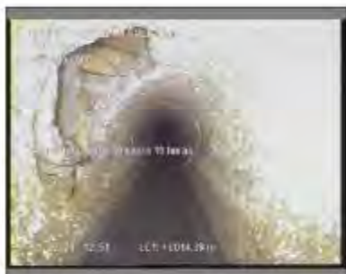
Foto: 40_1_5_23022021_125344_A.JPG 14,6m, Acometida desde 09 hasta 10 horas
