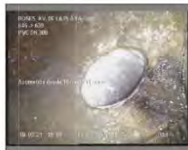
Foto: 21_1_4_18022021_160127_A.JPG 11,7m, Acometida desde 10 hasta 11 horas
