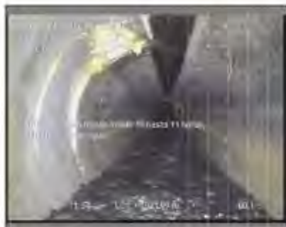
Figura 36: Erosió de la solera entre pous de registre 463 - 474
