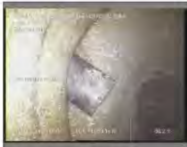
Foto: 14_1_5_18022021_111314_A.JPG 53,1m, Acometida desde 06 hasta 07 horas
