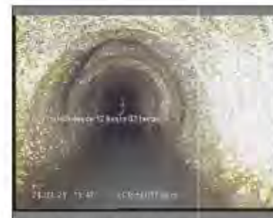
Foto: 43_1_7_24022021_114940_A.JPG 37,8m, Acometida desde 12 hasta 02 horas
