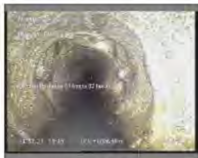
Foto: 43_1_4_24022021_114749_A.JPG 27,3m, Acometida desde 01 hasta 02 horas
