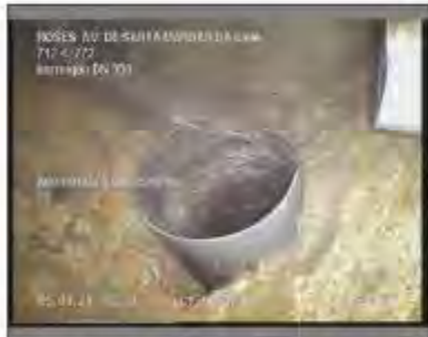
Foto: 60_1_7_05032021_122619_A.JPG 27,9m, Acometida a las 03 horas
