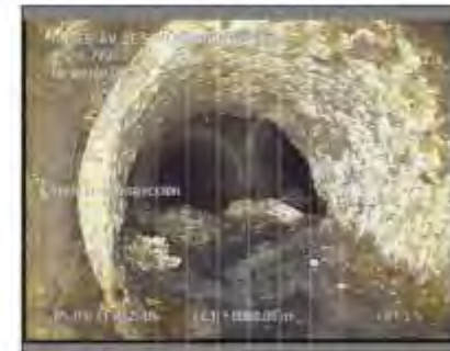
Figura 25: Fallada estructural del col·lector entre pous de registre 773 – 712
