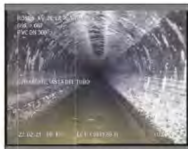
Foto: 26_1_9_22022021_094455_A.JPG 45,5m, Comentario
