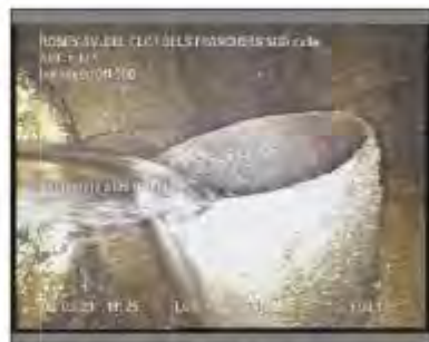
Foto: 19_1_5_02032021_112729_A.JPG 27,6m, Acometida a las 03 horas
