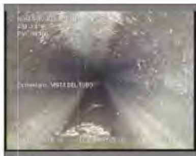
Foto: 4_1_5_24022021_092317_A.JPG 46,2m, Comentario
