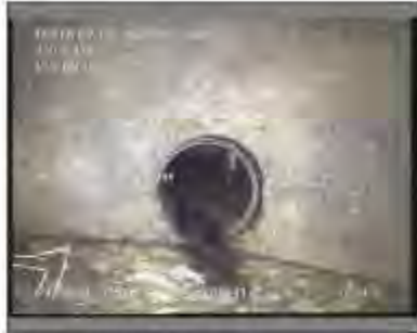
Foto: E_1_B_24022021_090518_A.JPG 33,6m, Acometida a las 12 horas
