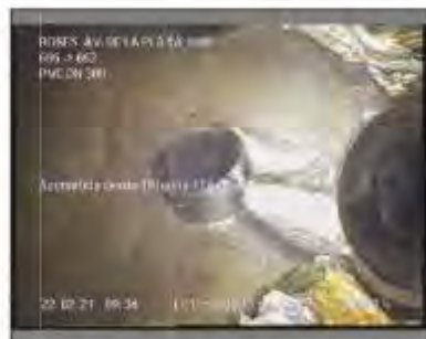
Foto: 26_1_7_22022021_093915_A.JPG 30,4m, Acometida desde 10 hasta 11 horas
