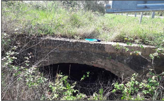
Vista aigua avall de la riera i de l'obra de pas d'accés als terrenys del marge esquerre de la carretera
