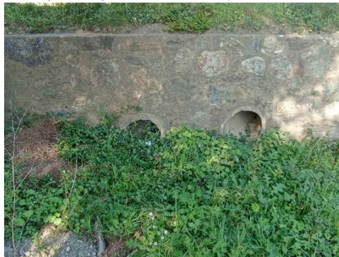
Imatge 18. Fotografies estructures hidràuliques escòrrec lateral
