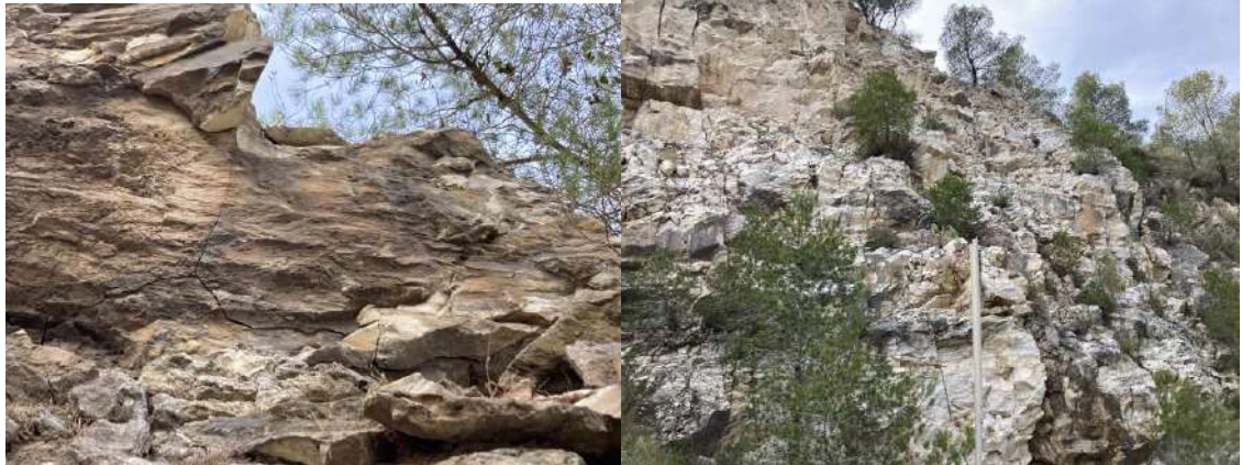
Fotografia 11: Fractures provocades per explotació minera. Ruptures de blocs molt erràtica.
